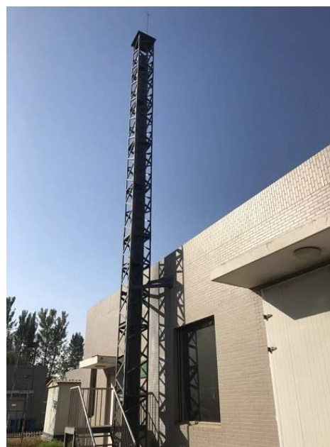
图 6 除臭间及排气筒 P1
