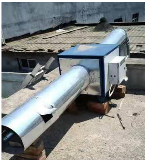
图 7 油烟净化器排气筒 P2
